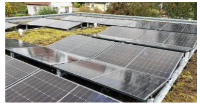
Die Solarpanels auf dem Unterkirchner Sportlertreff sind so angebracht, dass sie den ganzen Tag über möglichst gleichmäßig Strom produzieren können.
