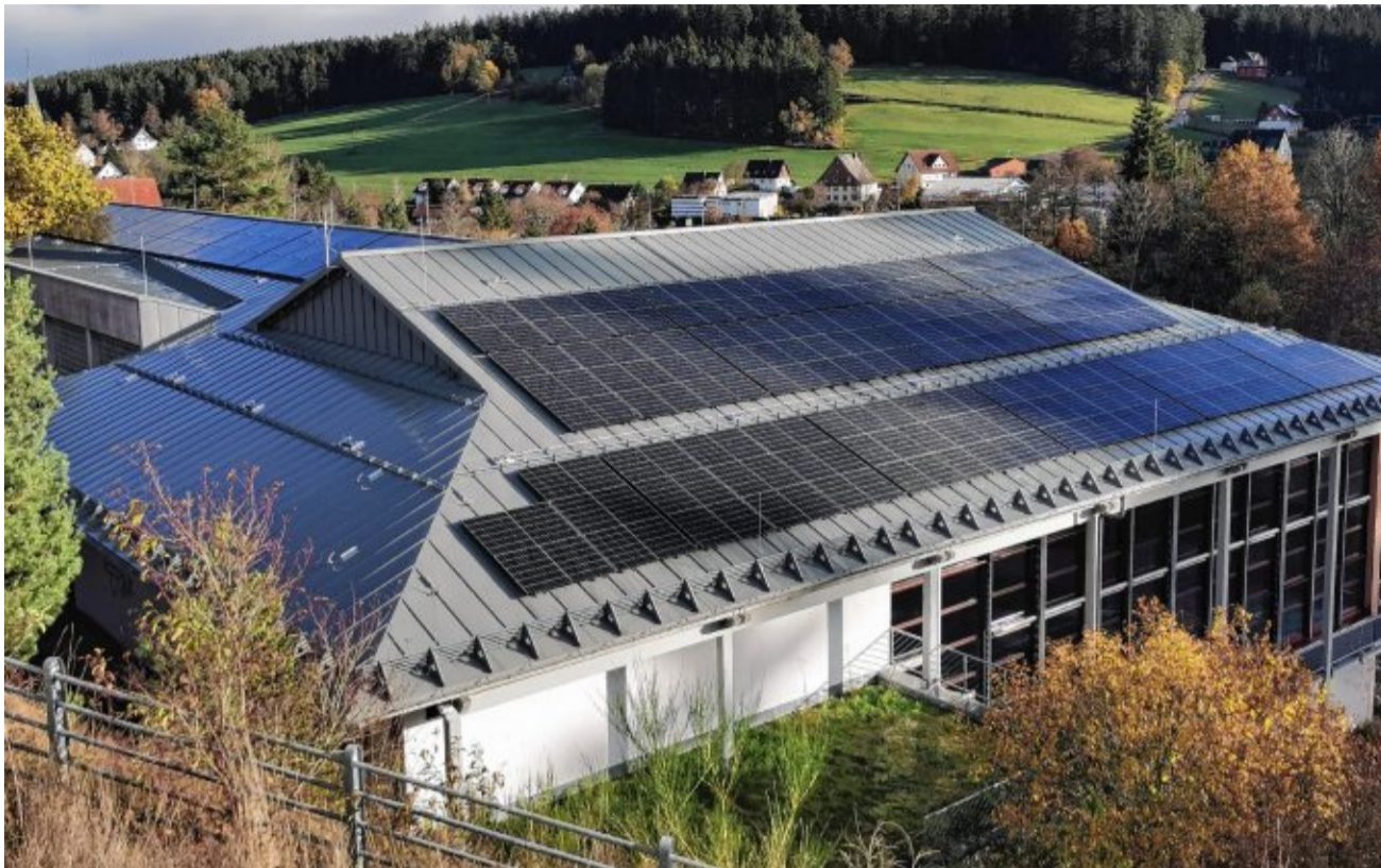
Auf einem Großteil der Dachfläche der Unterkirnacher Schlossberghalle sind PV-Module angebracht. Die Anlage ist jetzt am Netz. Die Gemeinde verkauft sie an die Bürgerenergiegenossenschaft und pachtet sie zurück. BILDER: CORNELIA PUTSCHBACH
